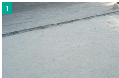
1 Nivelamento e compactação do subleito e execução da base de concreto magro.
